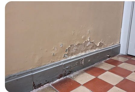
Humidité ascensionnelle entraînant la détérioration des enduits et de la peinture sur un mur situé au rez-de-chaussée sans caves
