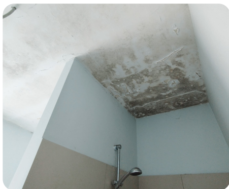
Condensation au plafond d'une salle de bains mal ventilée entraînant des détériorations et des moisissures
