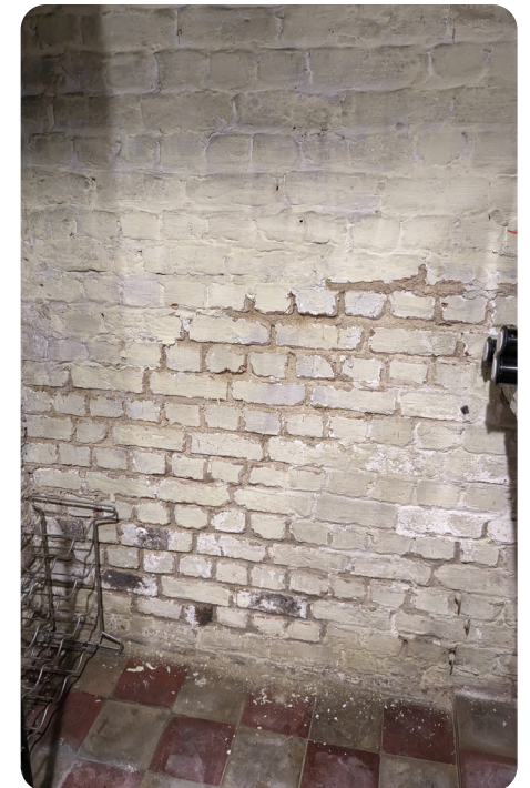
Humidité latérale d'un mur de cave contre terre entraînant la détérioration des joints des briques
