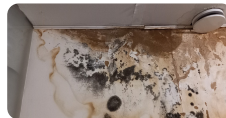
Auréoles foncées sur un mur d'un local sous une toiture plate dues à une étanchéité de toiture vétuste et percée
