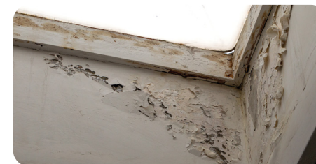
Effritement de peinture sur l'encadrement d'une coupole de toit plat du fait d'une mauvaise étanchéité entre celle-ci et la toiture plate
