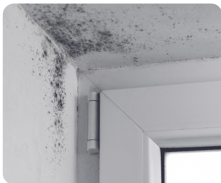
Condensation autour d'un châssis du fait de la présence d'un pont thermique et d'un manque de ventilation des locaux
