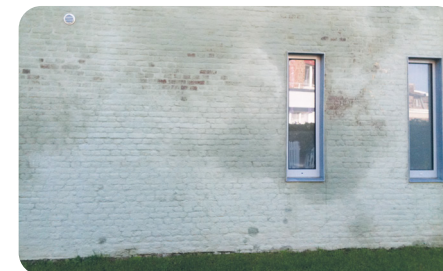
Tache d'humidité en façade due à la présence de nitrates dans la maçonnerie © CSTC-Digest n°13 de 2016 (NIT Recap-13)
