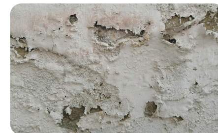
Dégradation de peinture due aux sels
